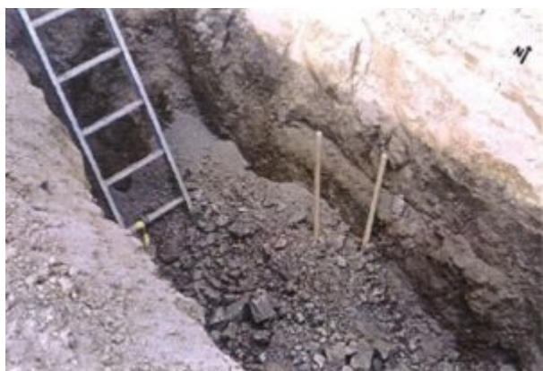
Figura 4. Escena del incidente (La víctima y su compañero de trabajo fueron enterrados cerca del extremo oeste de la trinchera.)
